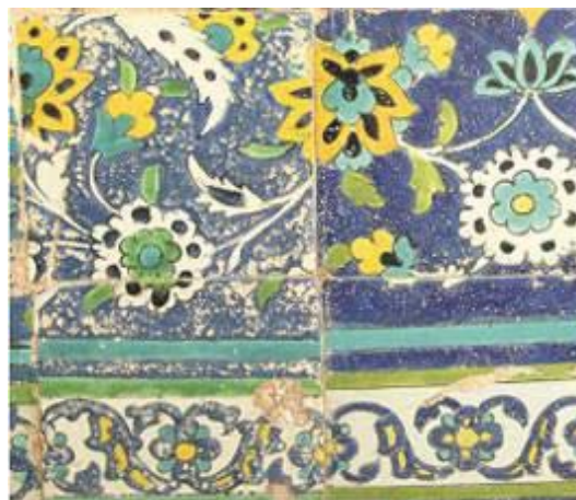
تصویر ۱۴. نمونه‌ای از کاشی تخریب شده و در حال تخریب به علت کیفیت ساخت پایین (منبع: نگارندگان)
